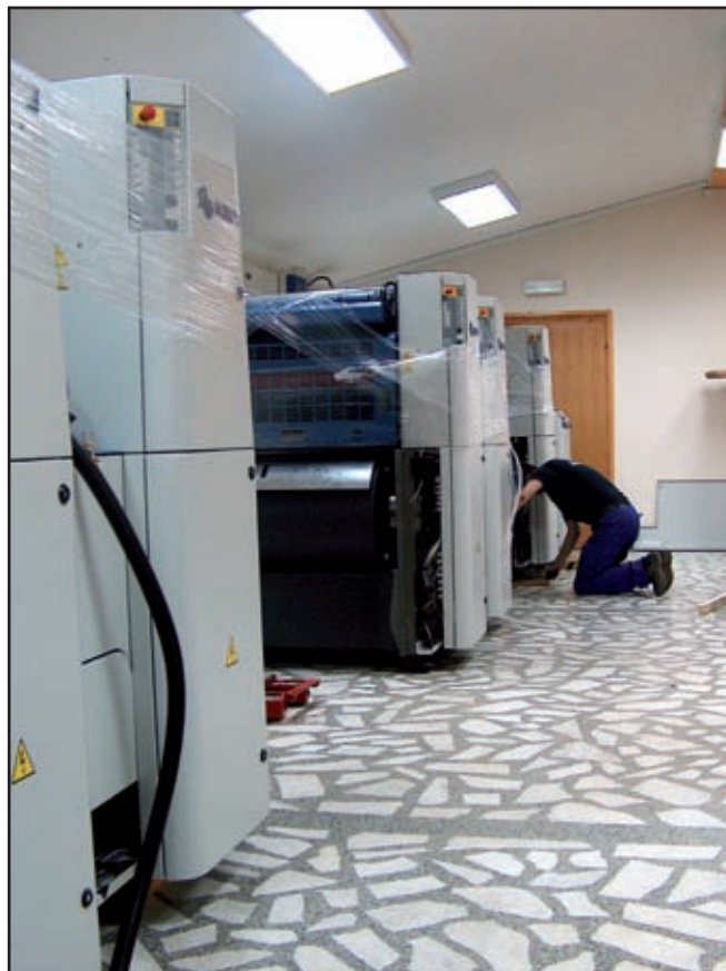
► Instalacija Performe 74 u prostorijama Grid-a
